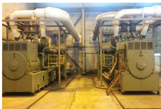
نگهداری و تعمیرات نیروگاه C-R دیزل پمپ‌های اضطراری فولادسازی
